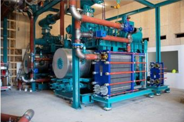
Kompressor med veksler fra Støvring Kraftvarmeværk
