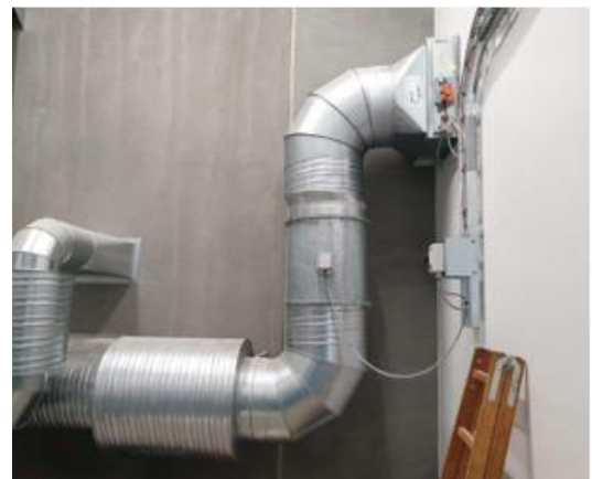
Ventilation automatisk styret spjæld (sikkerhed) luftskifte i bygningen reguleres automatisk som sikring mod kølemiddeludslip
